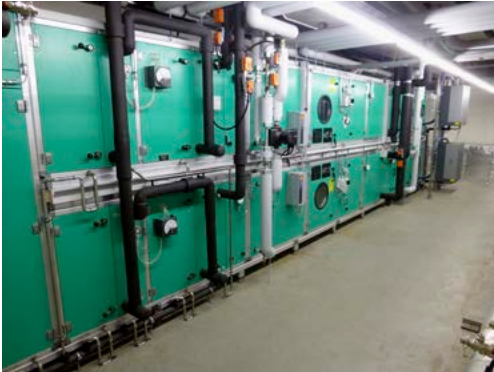
Un système spécial de ventilation permet une circulation de l'air de l'extérieur vers l'intérieur, en maintenant un différentiel de pression entre chaque pièce.
